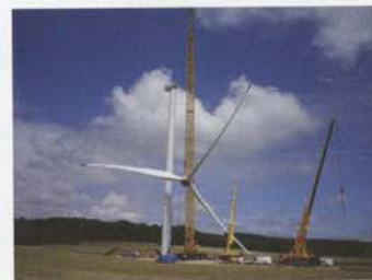
Exemple de montage du rotor.
